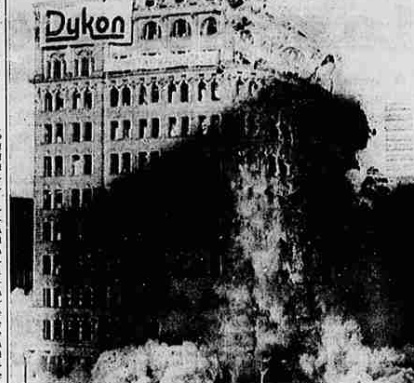
St. Louis. E' una scena consueta per gli Stati Uniti: il palazzo Bader, 12 piani e con un secondo di via, è stato abbattuto per fare posto a un moderno centro commerciale. L'abilità degli artigiani l'ha fatto affossare senza causare danni intorno (Telcelco United Press)
